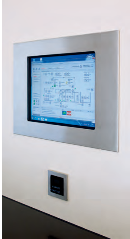
Das einzige Wandpanel im Haus, das beim Treppenaufgang an der Rückseite der Küche angebracht ist, bietet dem Bauherrn einen Überblick über alle Anwendungen, die ans KNX-System angeschlossen sind.
