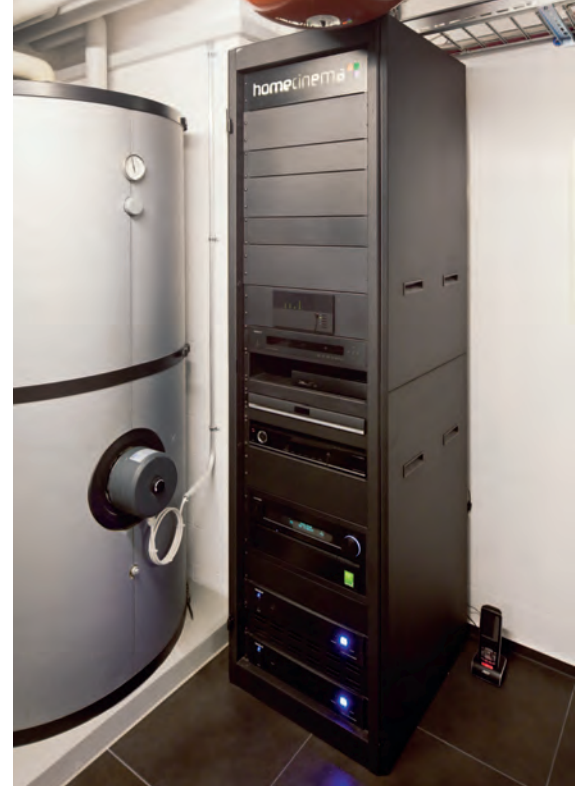
Im Technikraum mit einem Tableau und zwei Racks bloss für die Vernetzung ist alles ordentlich verstaut.
